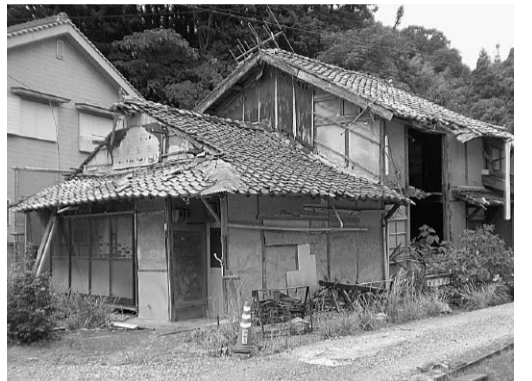
管理されていない空き家
