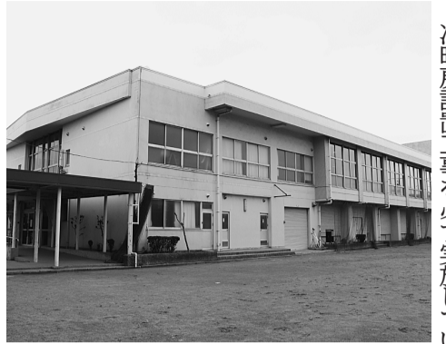
冷暖房機器の設置を予定している常盤中学校体育館
