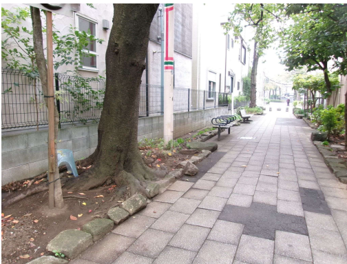
樹木の根上がりで縁石が凸凹になった歩道
