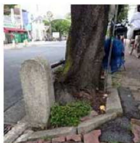
樹木の根上がりで凸凹になった歩道の舗装 出典：葛飾区街路樹管理計画
